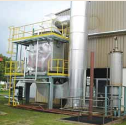
Economiser yang dipasang di Kilang Chembong.
