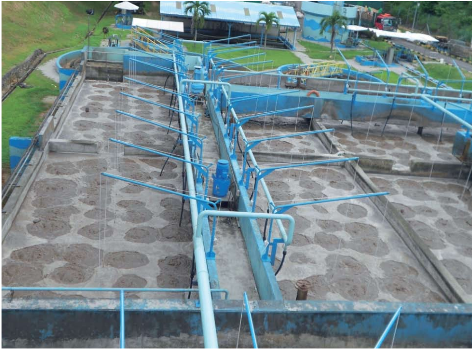
Gelembung peresap di loji rawatan sisa air kami di kilang Chembong.
